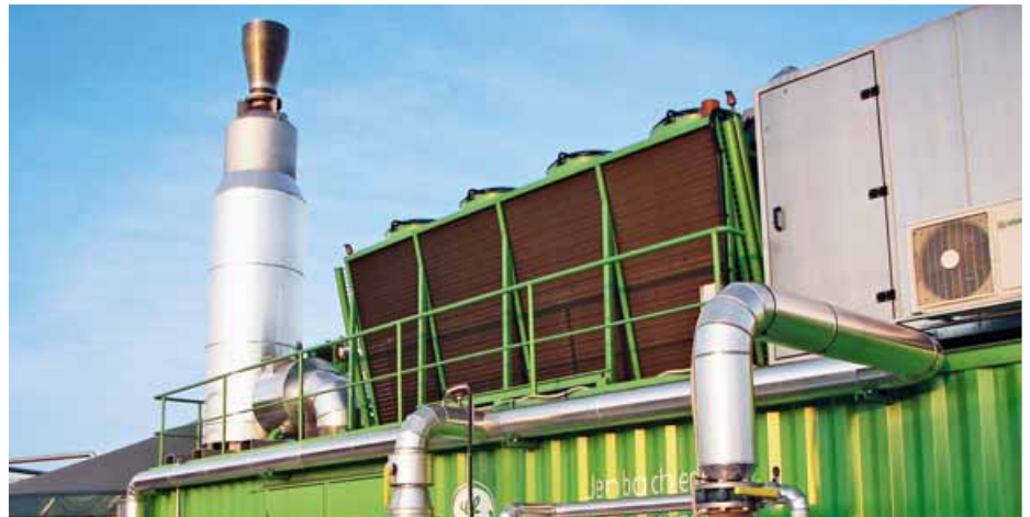
I sottoprodotti che derivano ad esempio da sfalci del verde urbano potranno essere sfruttati in un impianto di biogas aziendale. Foto: Archivio Aiel
