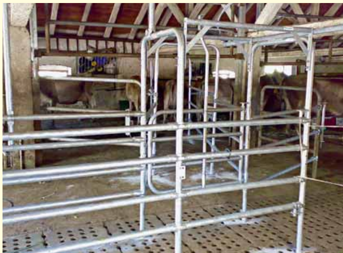
Foto A - Cannello separatore installato all'ingresso della sala di attesa della malga Juribello
