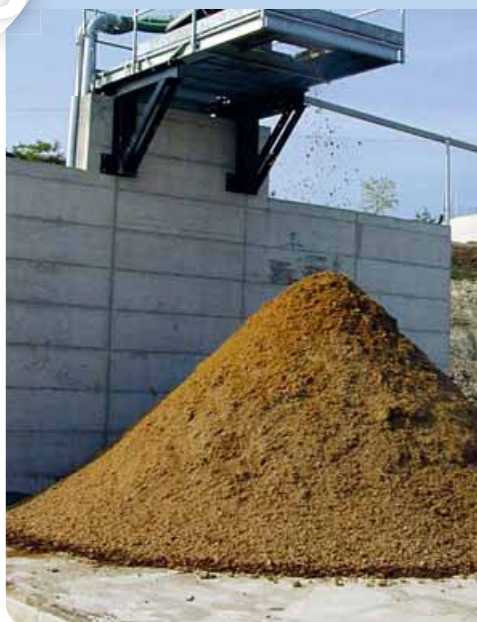
Impianto di separazione meccanica di liquame bovino
